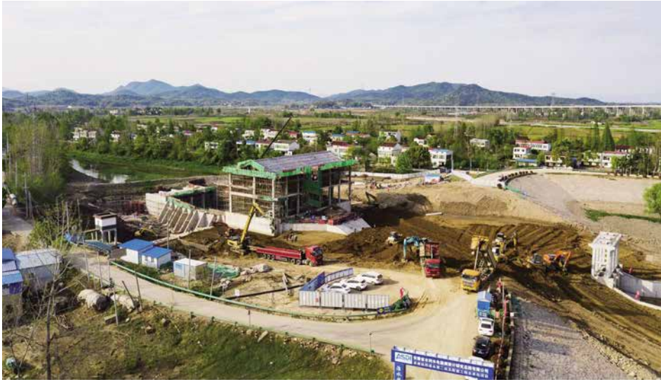
2020年4月7日,建设中的水利薄弱环节建设性治理工程永赖电排站
