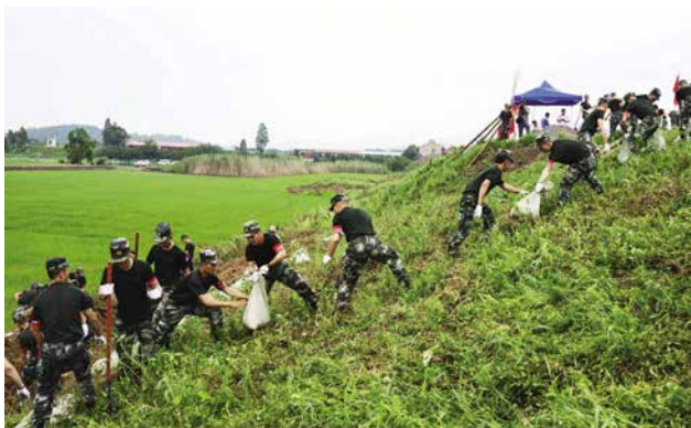
2020年7月14日,项铺镇唐山联圩许潭圩段出现近400米长滑坡,武警安徽总队预备特战队集训队80余名官兵与该镇群众合力排除险情 (汪华君/摄)
