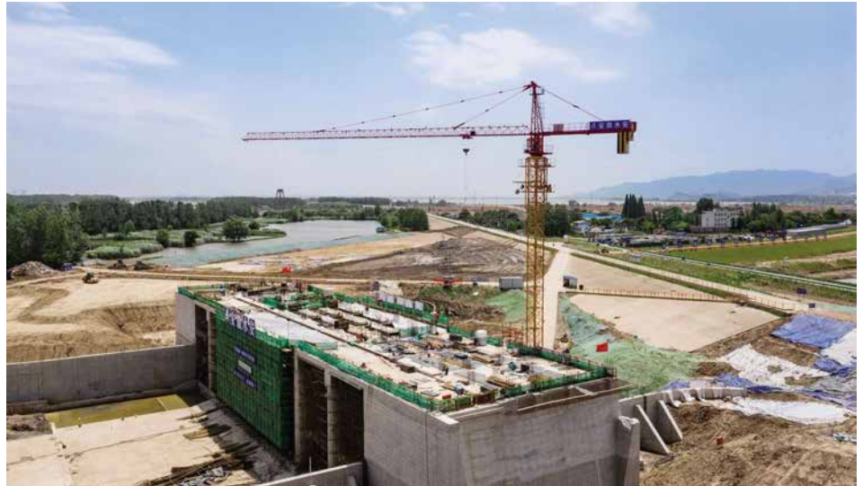
2020年5月18日,枞阳引江济淮枢纽节制闸主体工程基本完成。新建船闸扩展到240米,通航能力1000吨,兼顾2000吨
