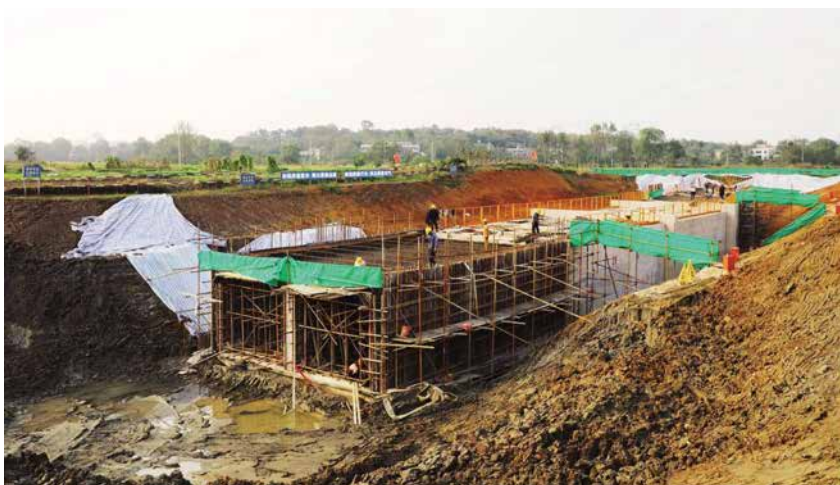
2020年10月19日,正在施工中的铁铜圩下站(排涝泵站)更新改造工程 (王章志/摄)
