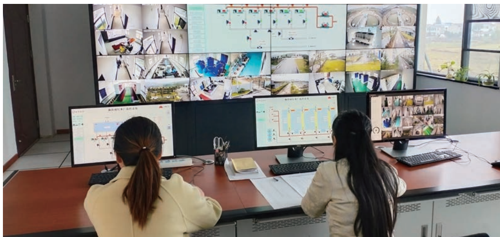
2019年10月1日,雨坛自来水厂试通水。图为该水厂工人监控设备运行情况 (汪翔/摄)
